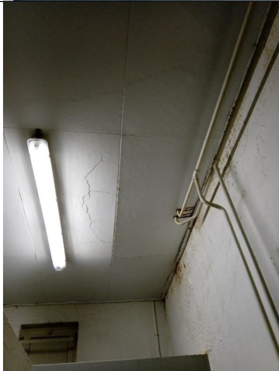
Lekkage plafond toiletgroep
