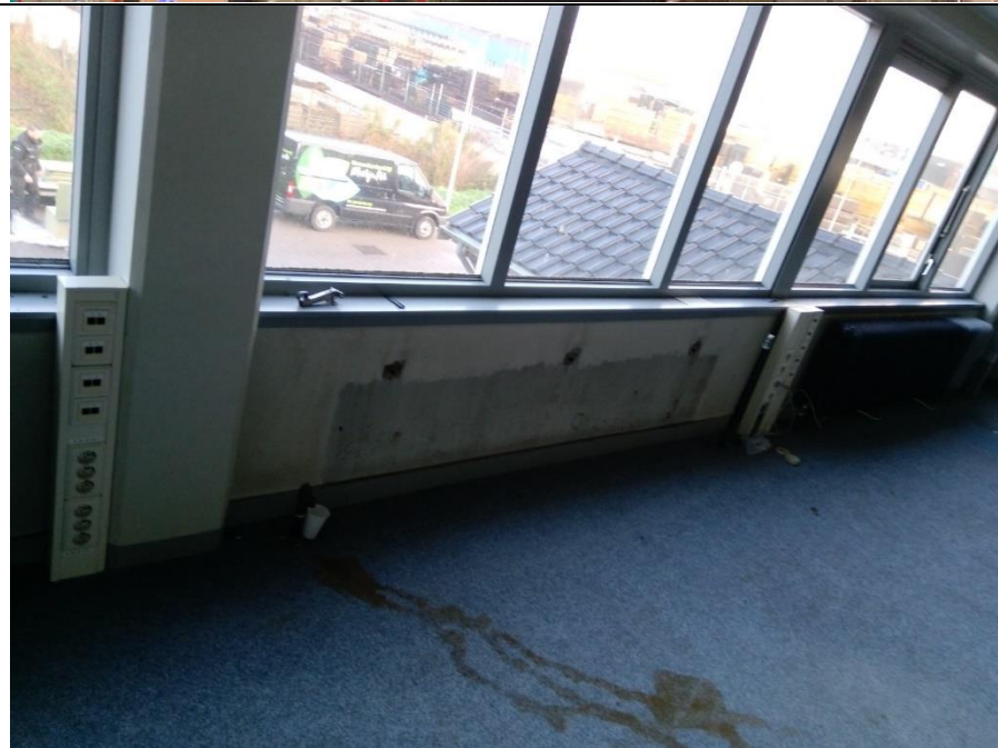
Radiator afgekoppeld bovenverdieping
