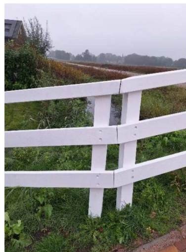
aansluitingen niet in lijn.
